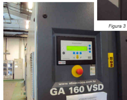
Figura 1 - Compressor GA 160 VSD da rede de 12kgf/cm 2 .
