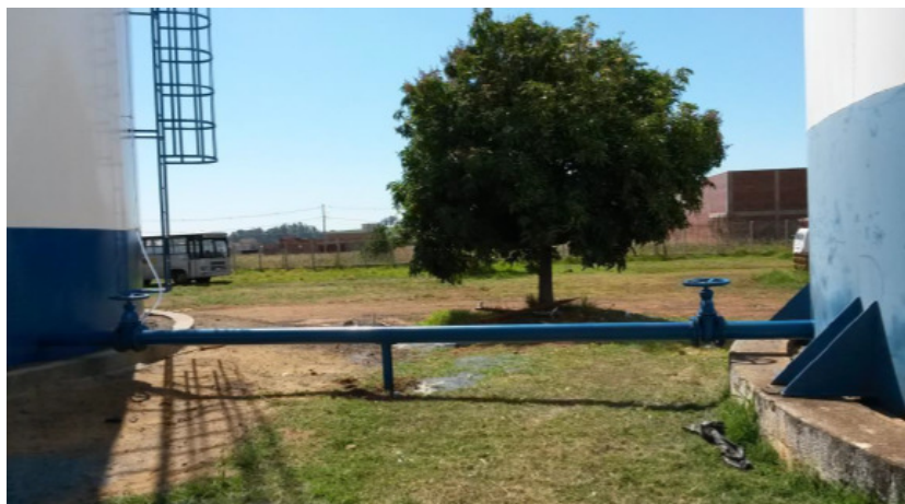
Interligação entre os reservatórios
