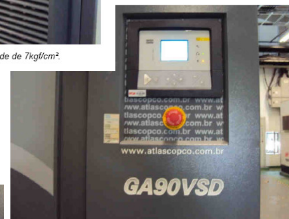
Figura 3 - Compressor GA 90 VSD da rede de 4,3kgf/cm 2 .
