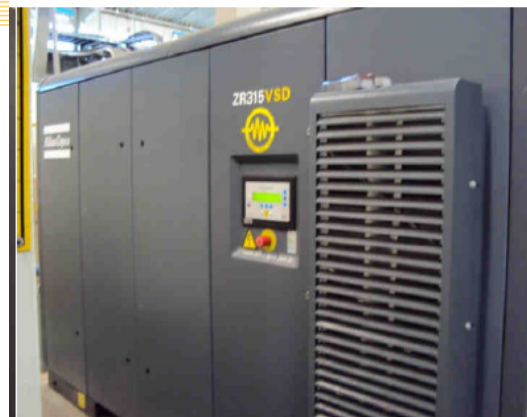
Figura 2 - Compressor ZR 315 VSD da rede de 7kgf/cm 2 .
